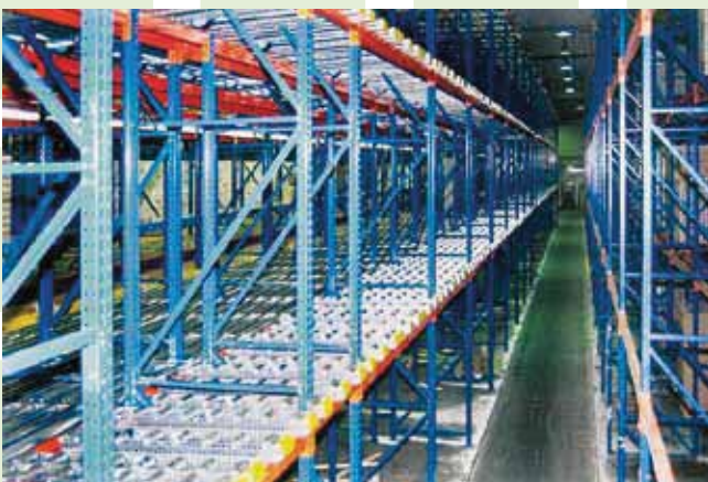
Kommissionierregalanlage mit Palettenrollenbahnen Aufgabe 2-geteilt für Staplerführung
