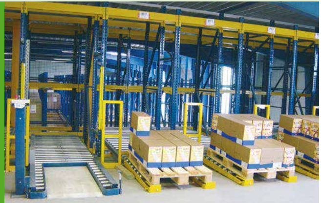
Übergabestation für Palettenkommissionierung
